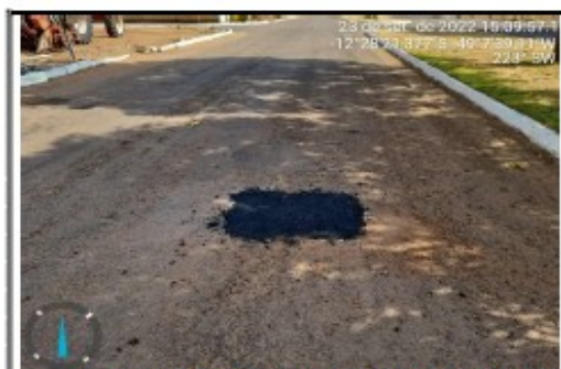
Foto 04 - Reparo da coleta da amostra 2 Av.Marechal Rondon
